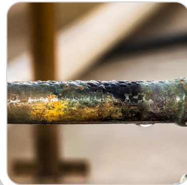
Auch die Kaltwasserleitung sollte gedämmt werden, um Kondensat zu verhindern
